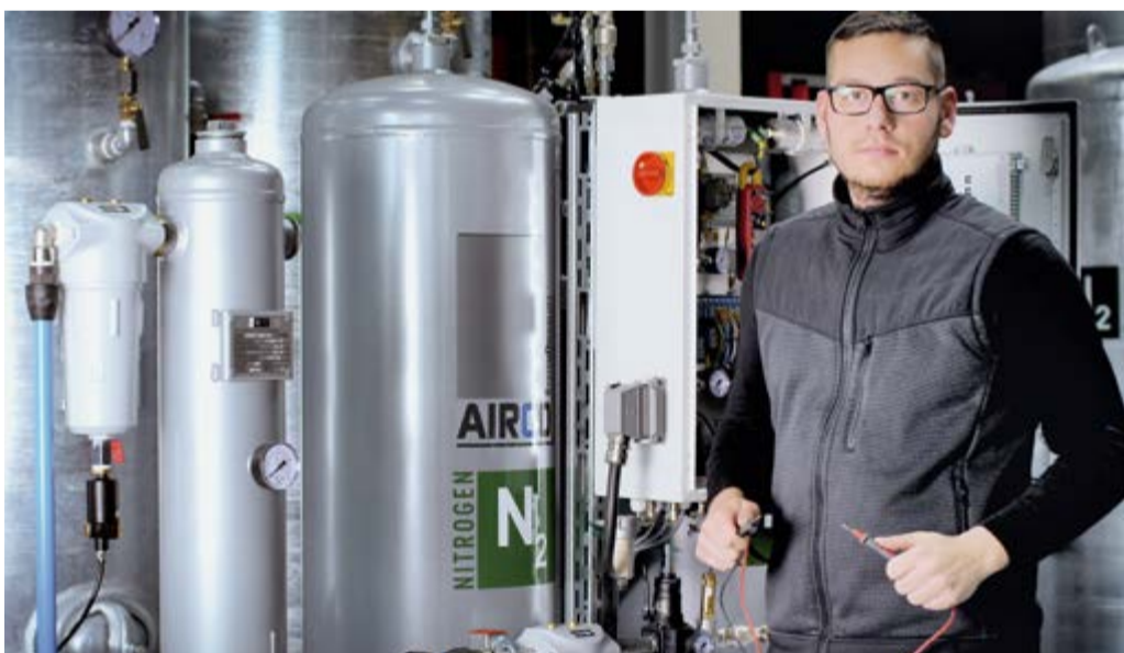
Servicetechniker Robin an einer Stickstoffanlage AIRCO.
