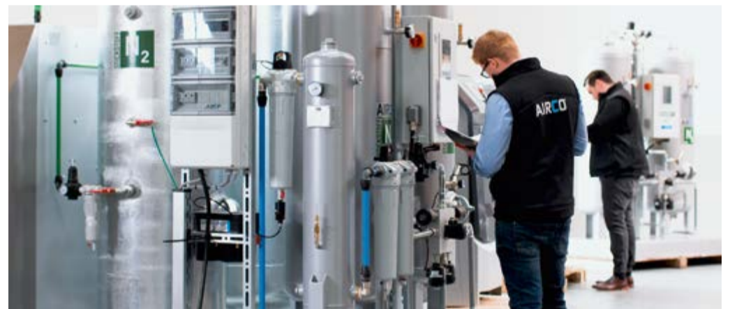
Robert und Philip bei der Abnahme von zwei Stickstoffanlagen.
