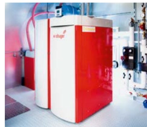
Einer von insgesamt drei Pelletkesseln, deren Einsatz die komplette Abkehr von herkömmlichen Brennstoffen und Wärmeträgern ermöglichte.
