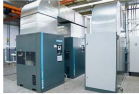
Die Druckluftanlage für „Hausluft“ und Stickstoff.
