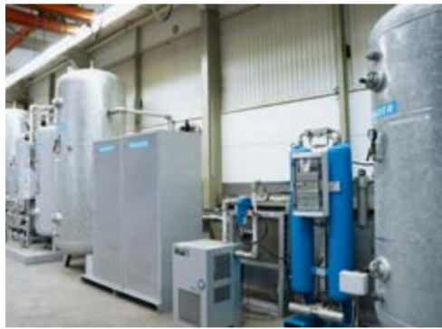
Stickstoffanlage mit Nkat-System und N2-Aufbereitung.
