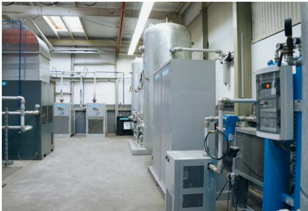
Blick in den Raum, in dem die Druckluft- und Stickstoffanlage stehen.
