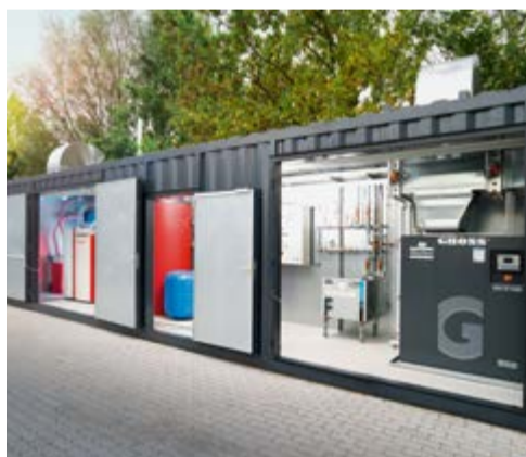
Die „Energie-Box“, eine hocheffiziente Containeranlage, die die Druckluftzentrale und die Heizzentrale beherbergt.
